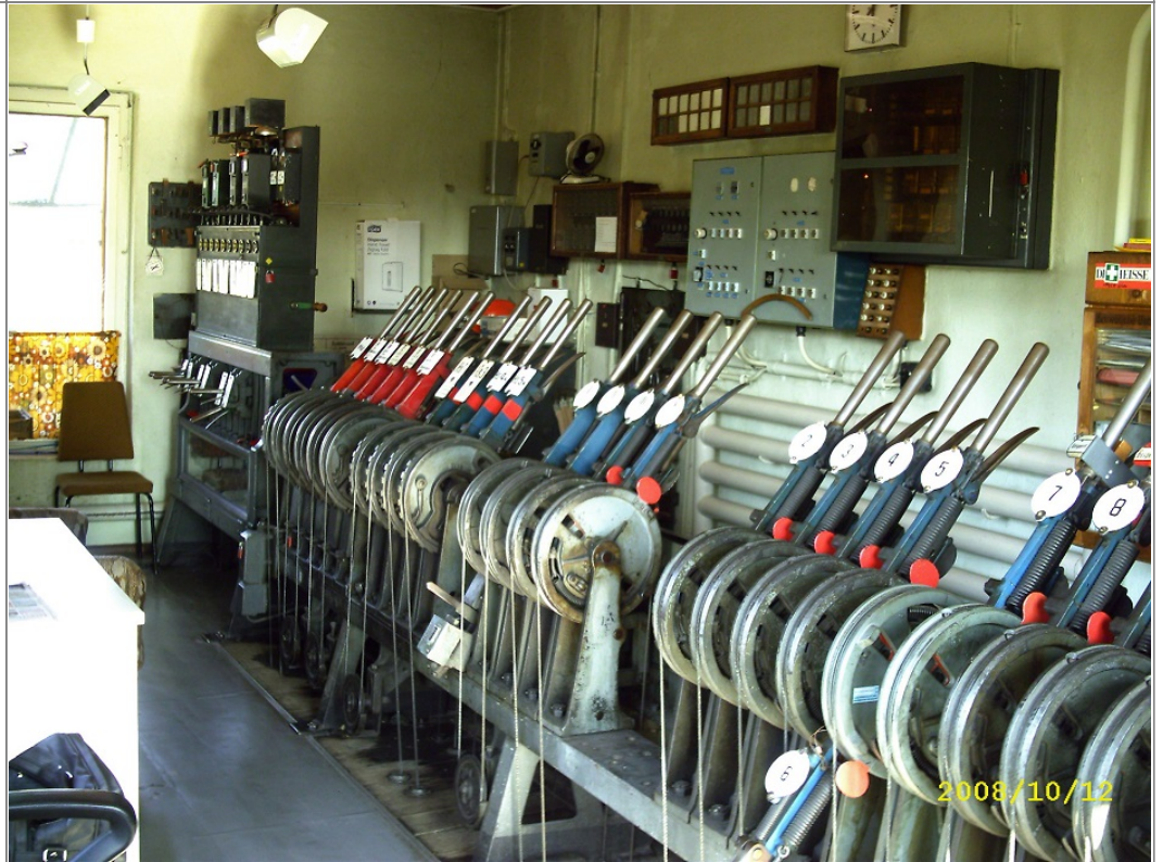
von 1936 - 1985 im Einsatz, das mechanische Stellwerk „Bauform C“
